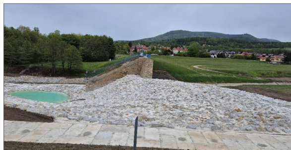
Rys. 53. Zapora w Stroniu Śląskim – tymczasowe zabezpieczenie po rozmyciu części korpusu ziemnego zapory 15 września 2024 roku. Fot. Tomasz Walczykiewicz
